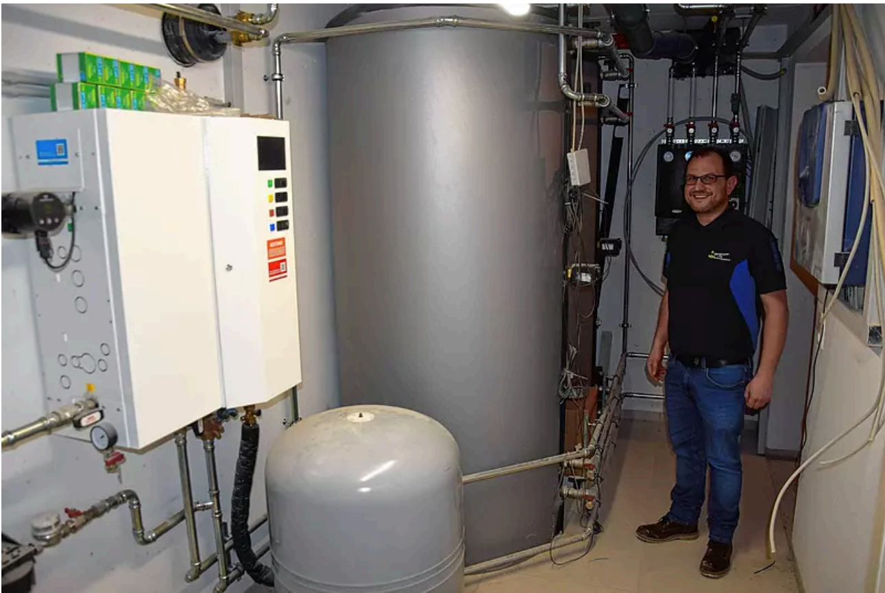
Der Vereinsvorsitzende Thomas Braun neben der neuen Heizungsanlage des Alten Schulhauses in Altenschwand. | Bild: Alexander Jaser
